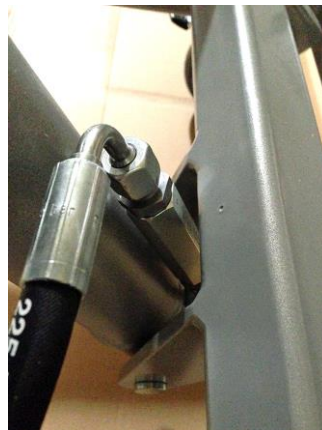
Senkregler am HTW eingebaut
