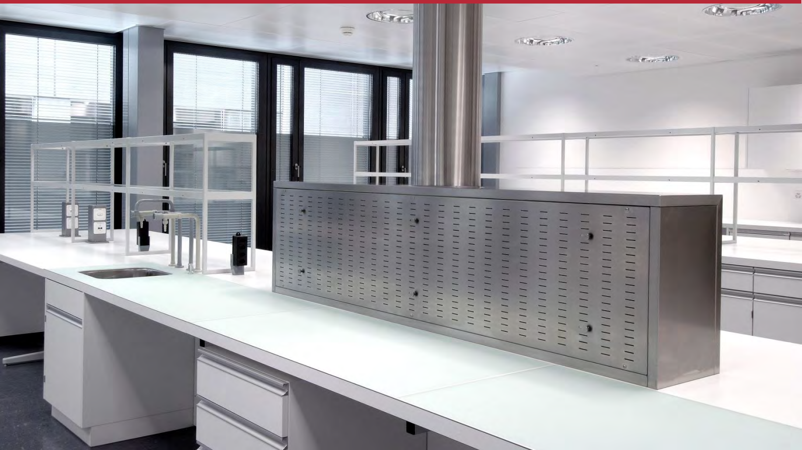
Foto oben: langer Labortisch aus Holz mit Melaminharzbeschichtung mit doppelter Rückwandabsaugung zur beidseitigen Absaugung von Schadstoffen
