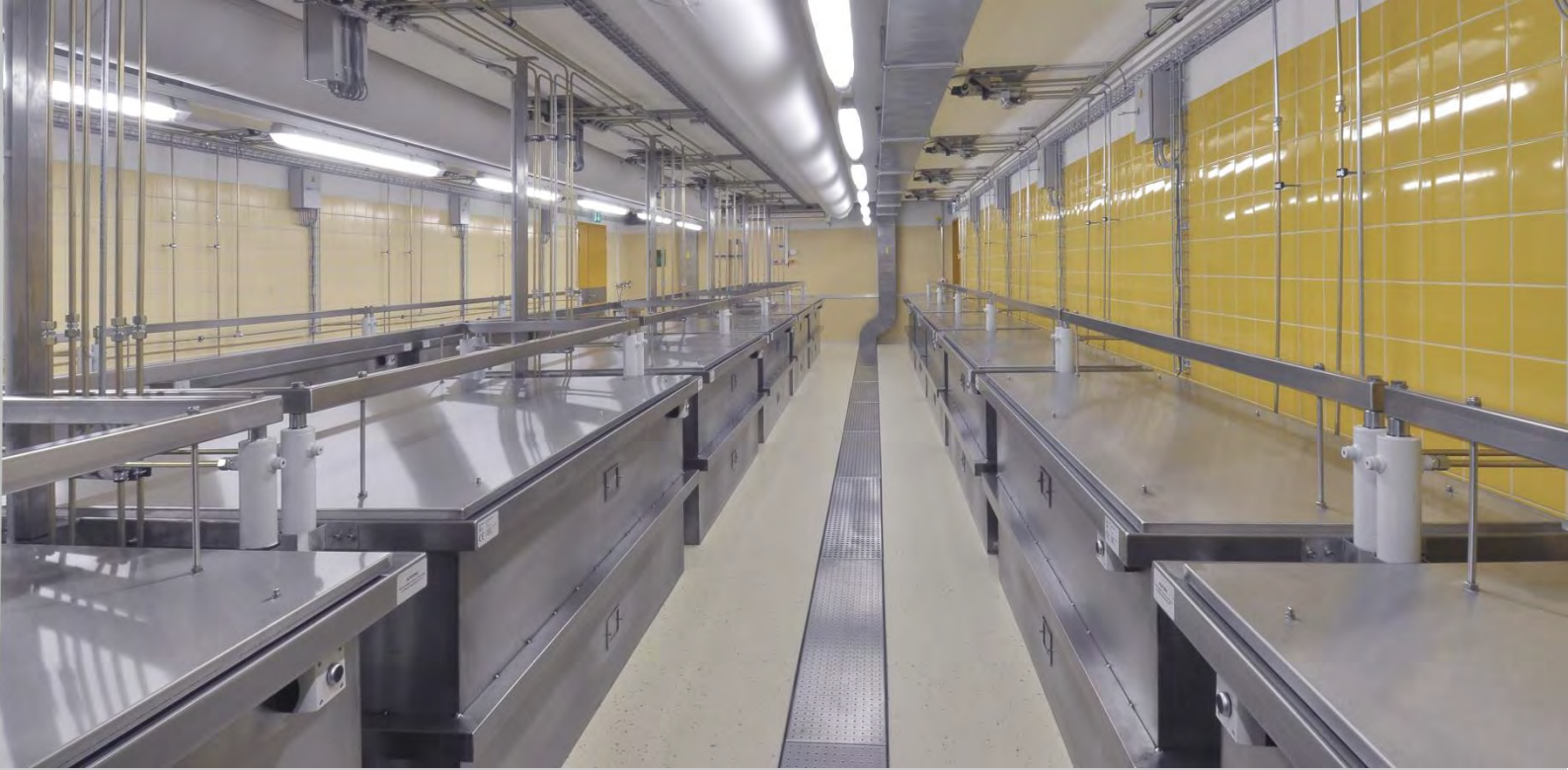
Foto oben: Leichenkonservierungsanlage mit 11 Einzelküvetten zur Lagerung von zwei Leichenmulden auf zwei Ebenen und 6 Doppelküvetten zur Lagerung von insgesamt vier Leichenmulden (zwei nebeneinander, zwei übereinander)
