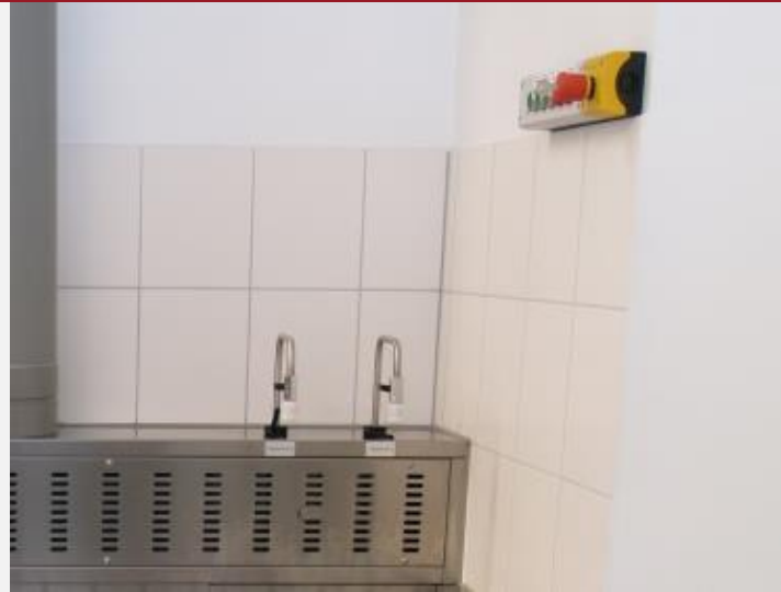
Rechts oben Steuerung der Dosieranlage mit NOT-AUS Taster
