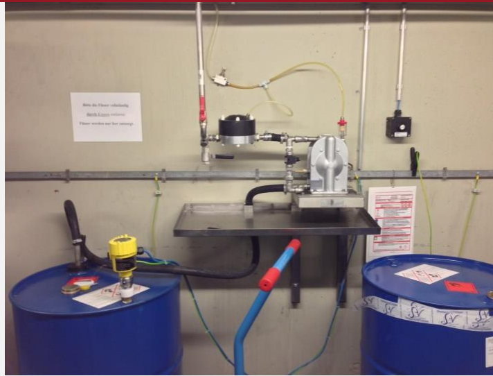
Xylol Pumpsystem, 200 Liter Stahlfass mit Füllstandssensor
