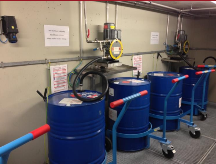
Ethanol Pumpsystem (100% Ethanol, 96% Ethanol) aus 200 Liter Stahlfässern – Aufstellung im Ex-Schutz Raum
