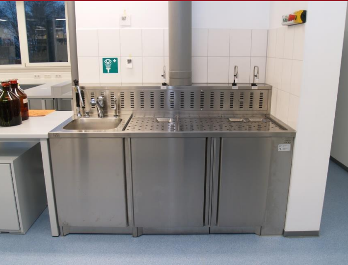
Dosier-/Entnahmesystem für Formalin, Ethanol und Xylol mit Luftabsaugung über Lochbleche nach unten und hinten
