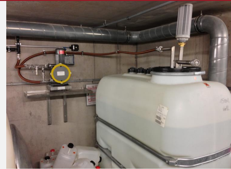
Formalin Pumpsystem mit 1500 Liter Vorratstank
