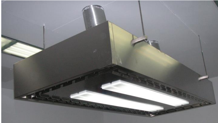
Zulufthaube mit Leuchtstofflampen
