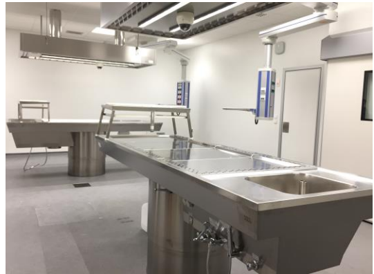
Zulufthaube mit LED Leuchten sowie Videokamera (kundenspezifische Lösung)
