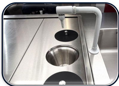
Sistema de dispensación de formol mediante pedal con accionamiento eléctrico
